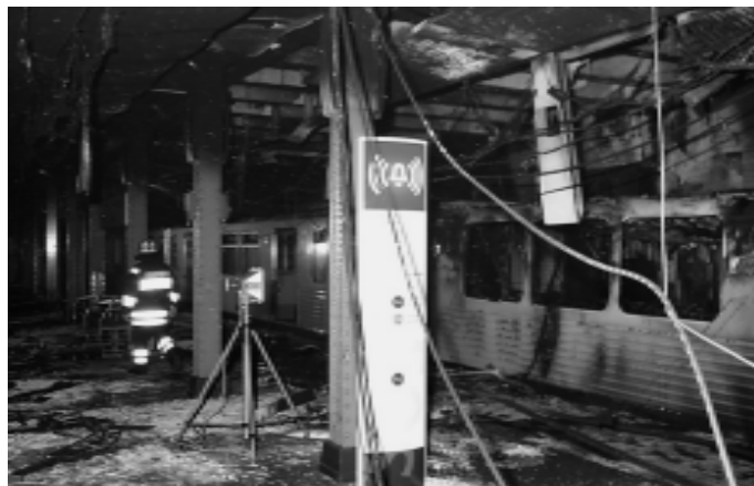
Brandschäden auf dem U-Bahnhof Deutsche Oper.
