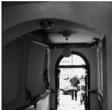
Zerstörte Wände im Eingangsbereich des Vorderhauses.
