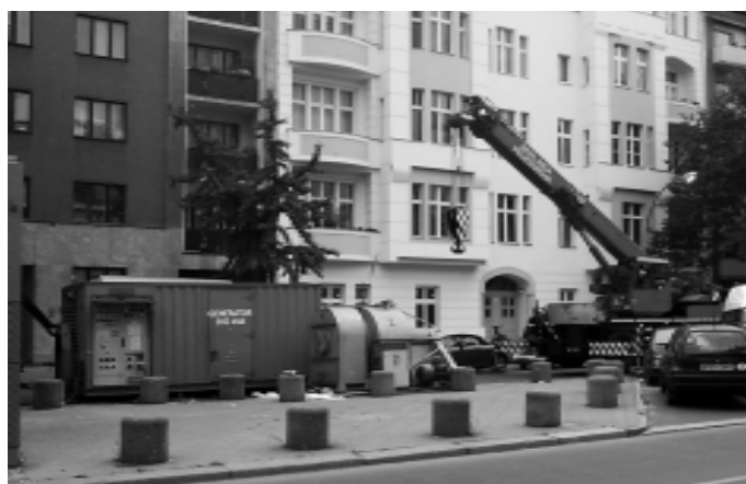
Hochleistungsventilator auf dem Notausstiegsschacht.
